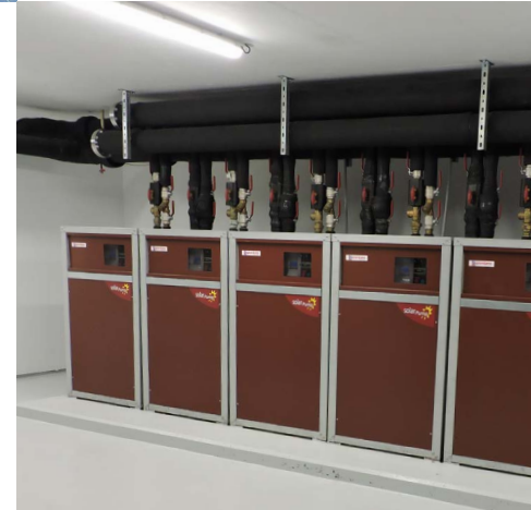
Pompe à chaleur eau-eau
