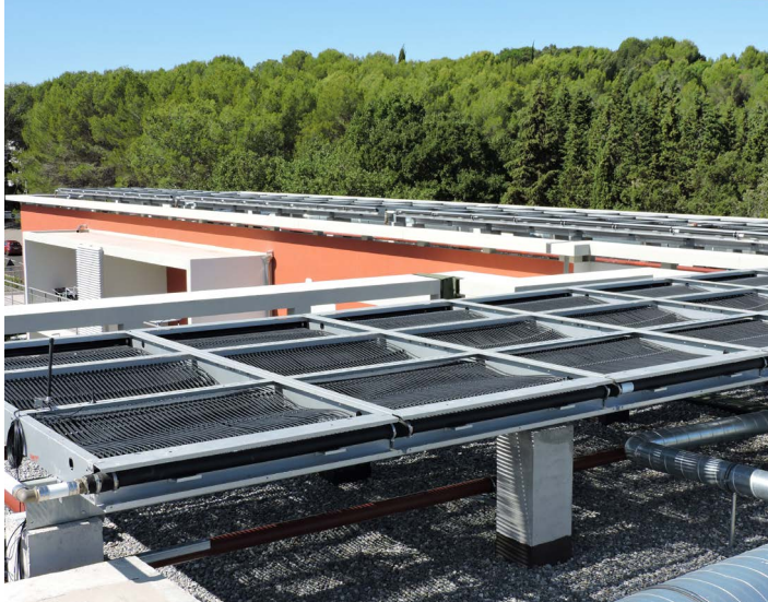
Système de production chaud-froid en toiture
